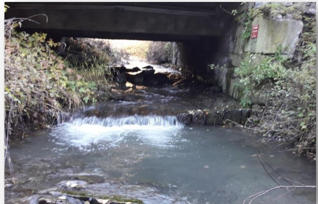
Figure 33 : Obstacle artificiel au droit du pont de la RD.
